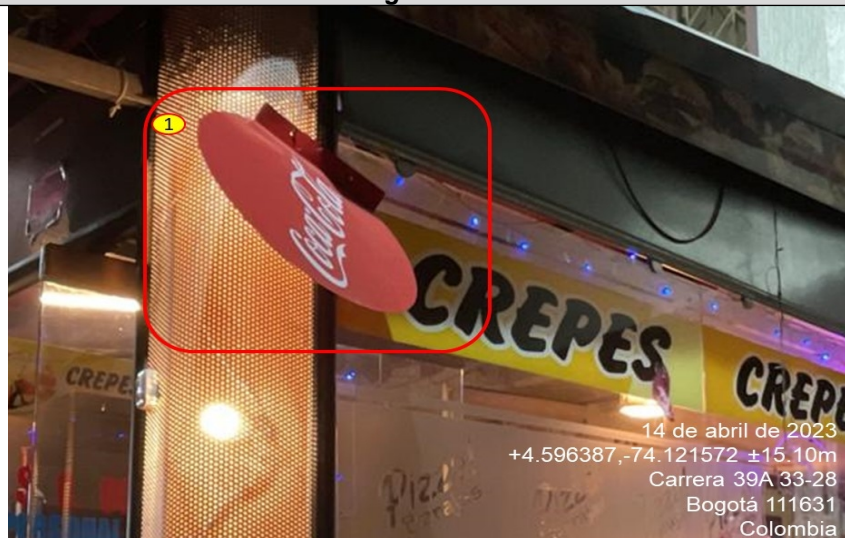
Elemento de PEV del establecimiento comercial, el cual se encuentra volado de la fachada de la edificación.
