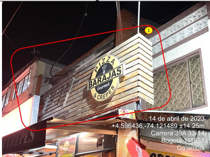
Elemento de PEV del establecimiento comercial, el cual se encuentra volado de la fachada de la edificación.
